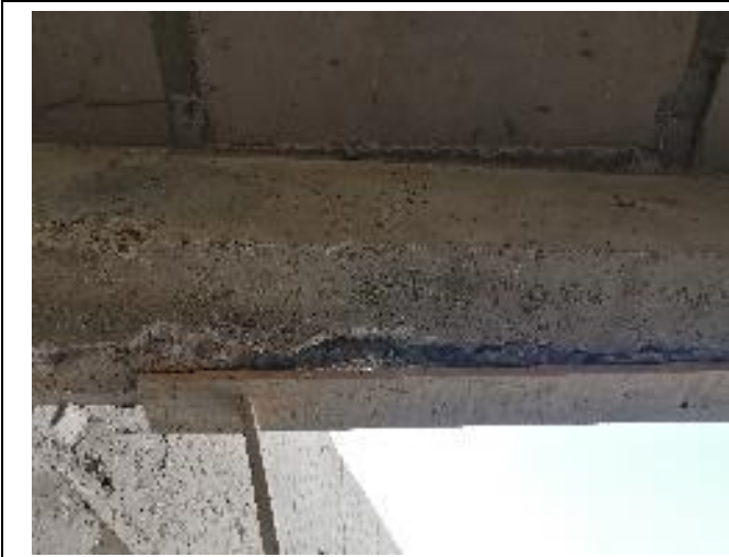
Fotografía N° 7: Viga con desprendimiento de hormigón y enfierradura a la vista.
