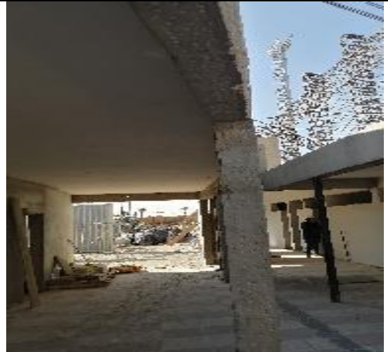
Fotografía N° 8: Eje D entre ejes 6 y 23, pilares fuera de los ejes.
