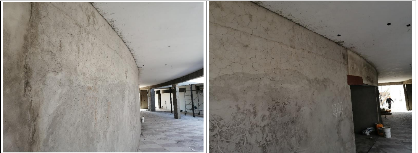
Fotografías N os 13 y 14: Presencia de grietas de tipo reticulares en el mortero de revestimiento continuo (estuco), en el muro del eje F.
