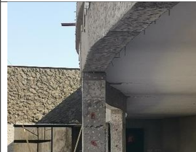
Fotografía N° 9: Eje D entre ejes 6 y 23, pilares fuera de los ejes.
