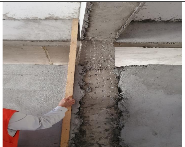
Fotografía N° 10: Área de Recreación, entre ejes C-E y 16-23. Incorrecta terminación en encuentro entre viga, pilar y losa.
