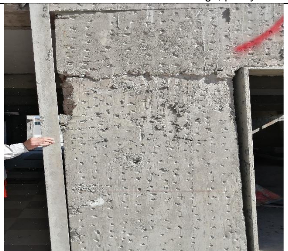
Fotografía N° 12: Muro desplomado con desprendimiento de hormigón.
