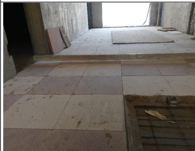
Fotografía N° 11: Área de Recreación, entre ejes C-E y 16-23. Pavimento desnivelado.
